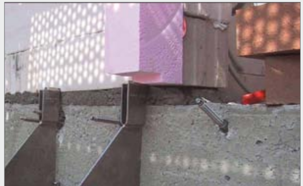
Auch hier fehlt der erforderliche Randabstand und der Dübel ist nicht nach den Angaben des Herstellers gesetzt.
